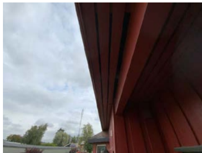
Synlige luftespalter i gesimskasse.
