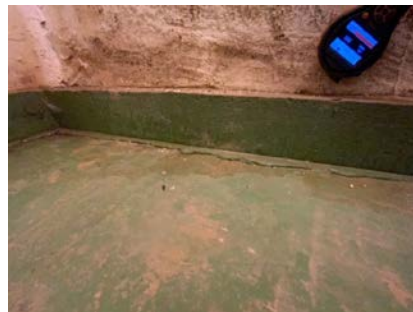
Påvist variable fuktverdier på nedre del av grunnmur.
