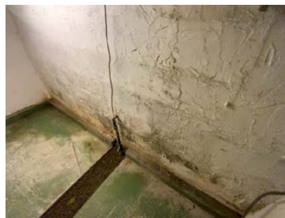
Overflater generelt bør utbedres.
