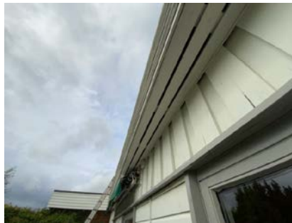
Synlige luftespalter i gesimskasse.
