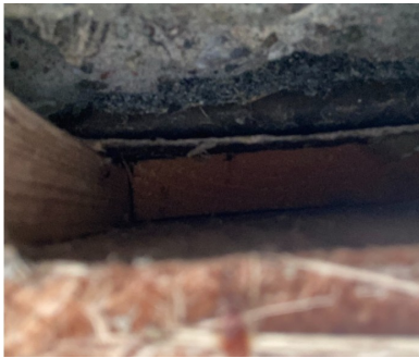
Det er ikke lufting bak bordkledning.
