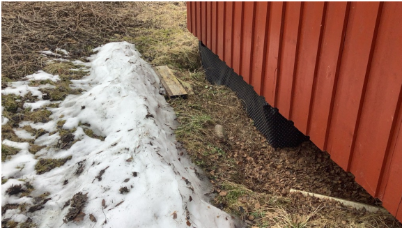
Utilfredsstillende fall fra bygning.
