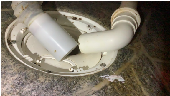
Plastsluk, og gulvbelegg er ført forbi slukets klemring.
