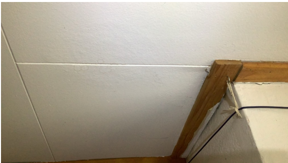
Svellskadet himling inntil pipe.
