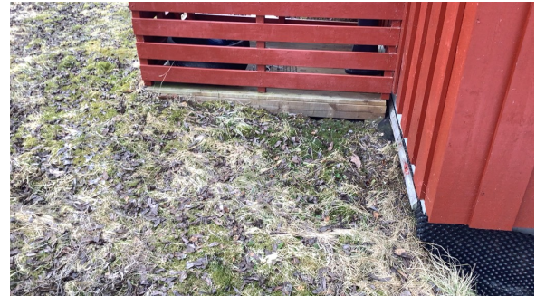
Utilfredsstillende fall fra bygning.
