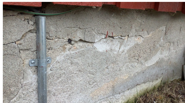
Eksempel på utvendig skrå- og horisontalriss.
