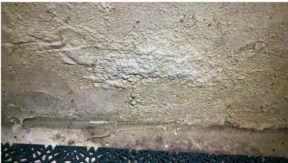
Eksempel på saltutslag.
