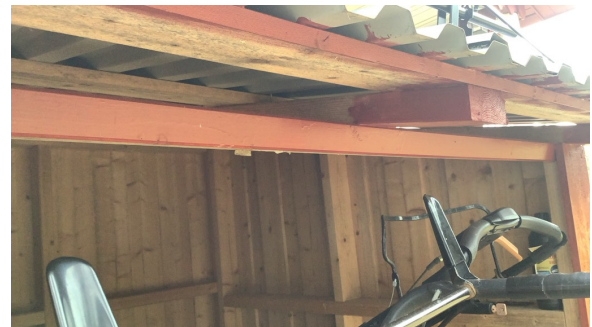
"Taksperre" er lagt på flasken, og opplagret på liggende plank over åpning.
