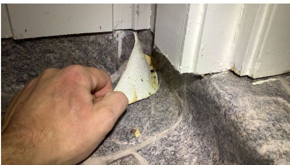
Eksempel på utett hjørne i gulvbelegget.
