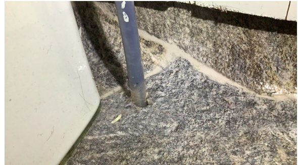
Utett gjennomføring i gulvbelegget.
