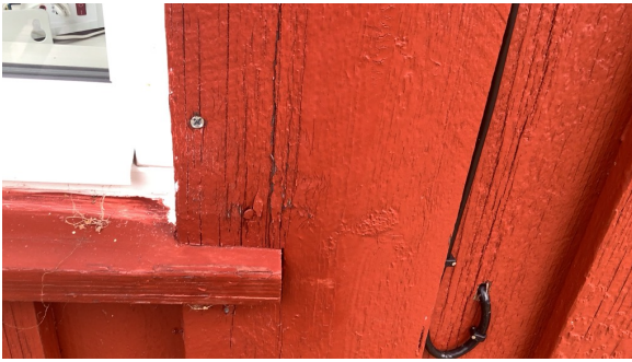
Eksempel på sprukket kledningsbord som er ført helt ned til vannbrett.
