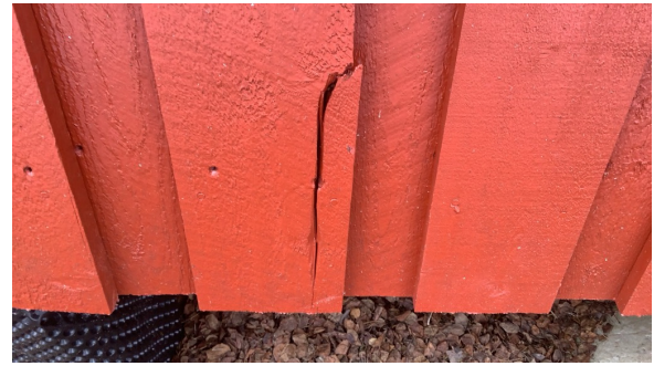
Eksempel på sprukket kledningsbord.
