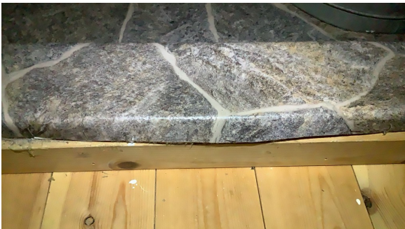
Løsnet gulvbelegg på utsiden av dørterskel.
