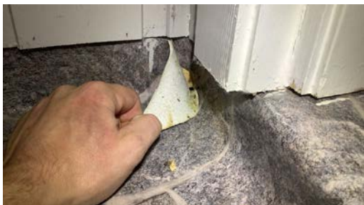
Eksempel på utett hjørne i gulvbelegget.
