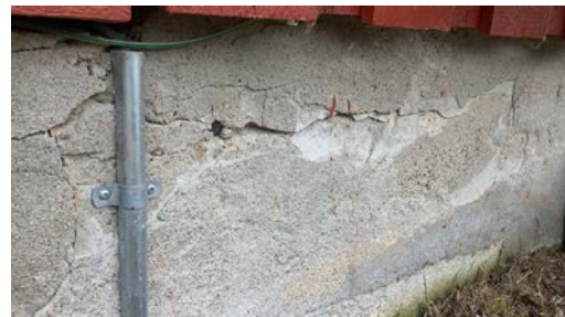
Eksempel på utvendig skrå- og horisontalriss.
