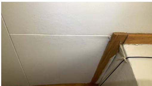
Svellskadet himling inntil pipe.
