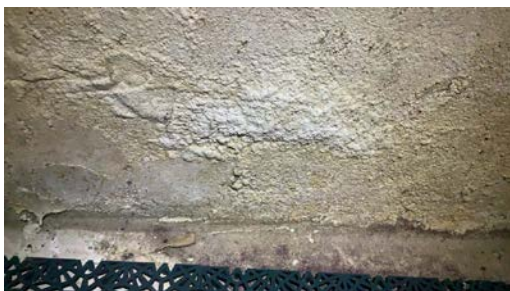
Eksempel på saltutslag.
