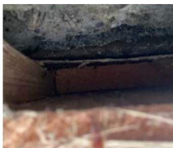
Det er ikke lufting bak bordkledning.
