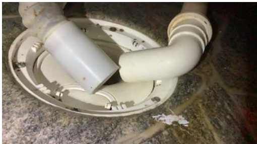
Plastsluk, og gulvbelegg er ført forbi slukets klemring.
