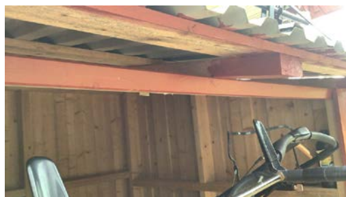
"Taksperre" er lagt på flasken, og opplagret på liggende plank over åpning.
