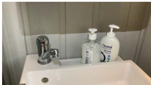
Det mangler tettesjikt i definert våtsone bak servant.
