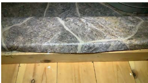
Løsnet gulvbelegg på utsiden av dørterskel.
