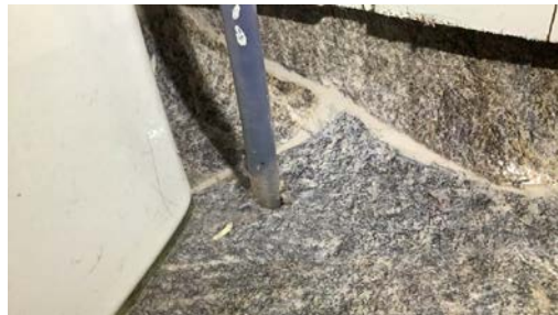
Utett gjennomføring i gulvbelegget.
