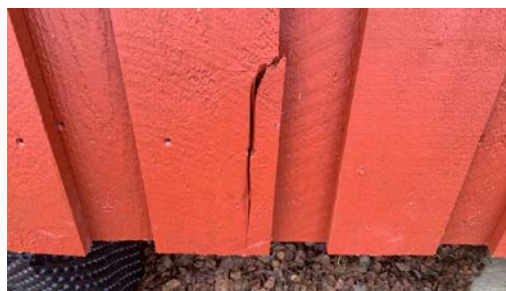
Eksempel på sprukket kledningsbord.
