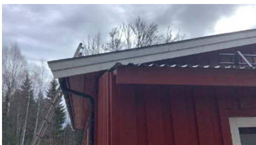
Det er ikke takutstikk, og risiko for regn bak kledning.
