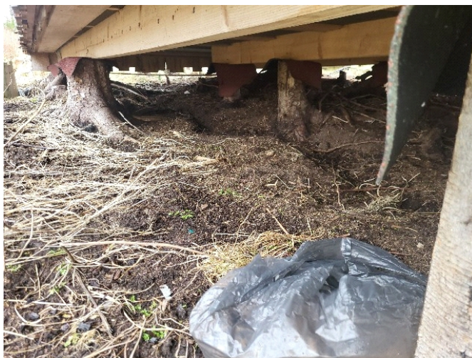
Fundamentering av kappede trær på flere av tilleggs hus på gården.
