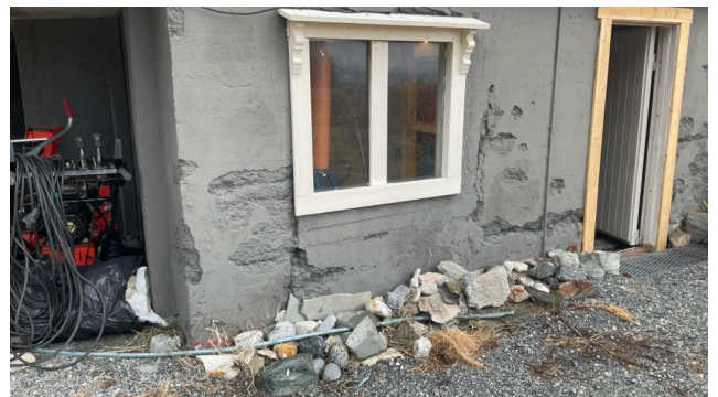
Store sprekker på grunnmur mot sør.
