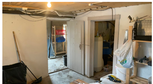
Løs kabel/ skjøteledninger i kjeller.
