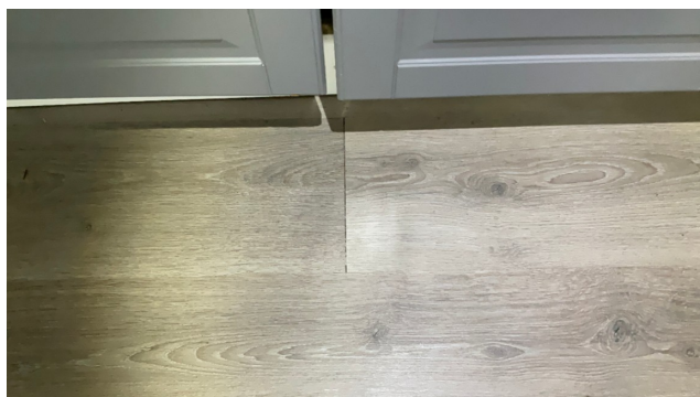
Glippe i skjøt på gulv i kjøkken.
