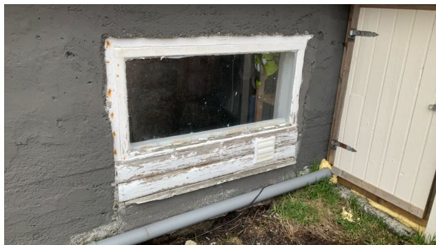
Koblede vinduer i kjelleretasje. Manglende beslag under vindu.
