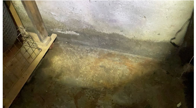
Saltutslag på gulv og vegg.
