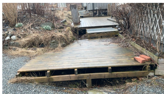
Skjevheter i markplatt mot vest.
