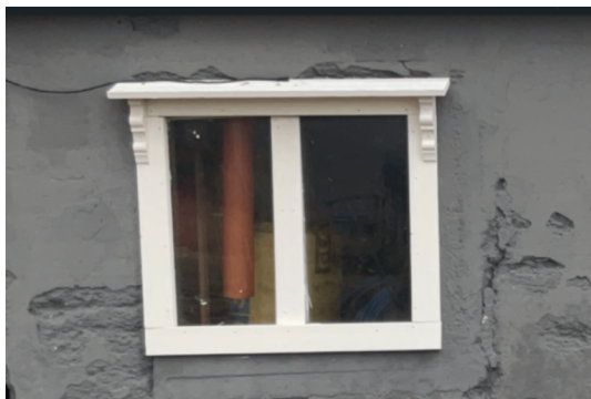
Omramming av vindu er ikke tett mot grunnmur. Vann vil ta seg inn mot karm
