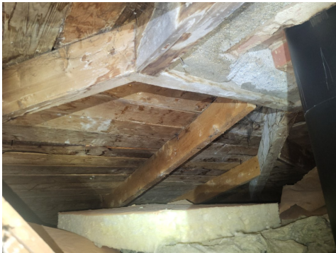
Fuktmerker i tro.
