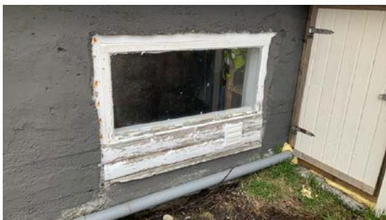
Koblede vinduer i kjelleretasje. Manglende beslag under vindu.
