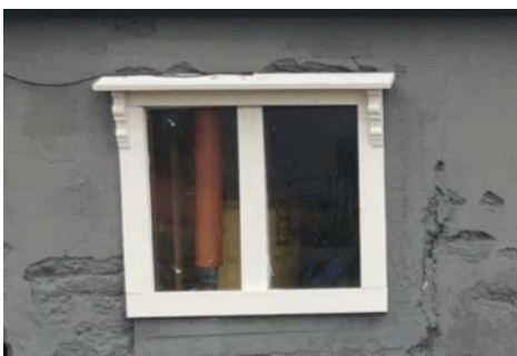
Omrømming av vindu er ikke tett mot grunnmur. Vann vil ta seg inn mot karm
