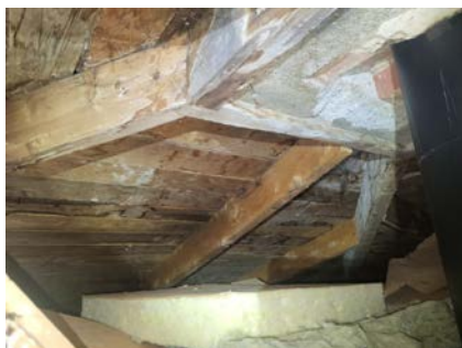
Fuktmerker i tro.
