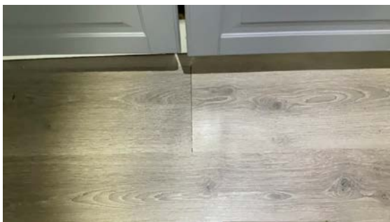
Glippe i skjøt på gulv i kjøkken.
