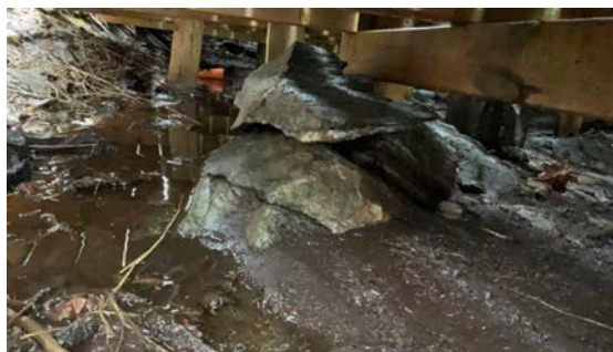
Grøft for vannavrenning under terrasse mot vest.
