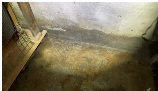
Saltutslag på gulv og vegg.
