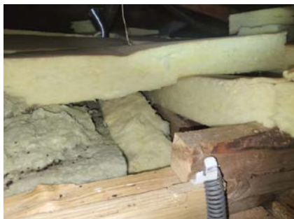
Isolering er ikke montert riktig, åpninger mellom isoleringsplater
