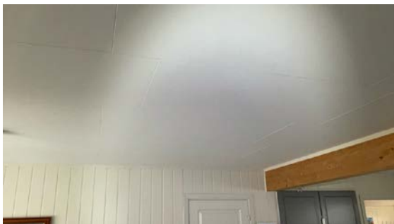
Ufagmessig montering av himlingsplater.
