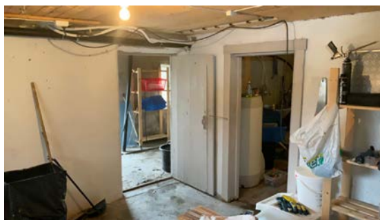
Løs kabel/ skjøteledninger i kjeller.
