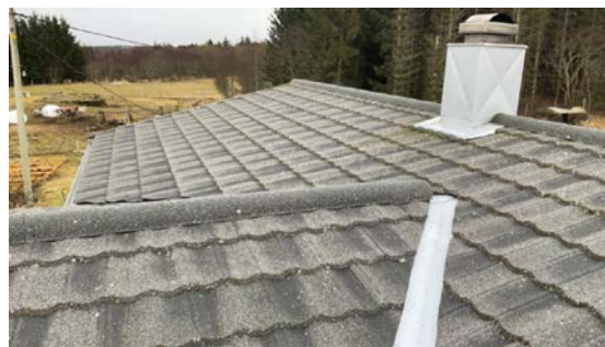
Små mosevekster på taket
