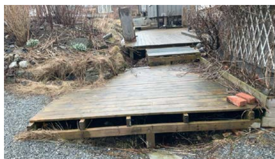
Skjevheter i markplatt mot vest.
