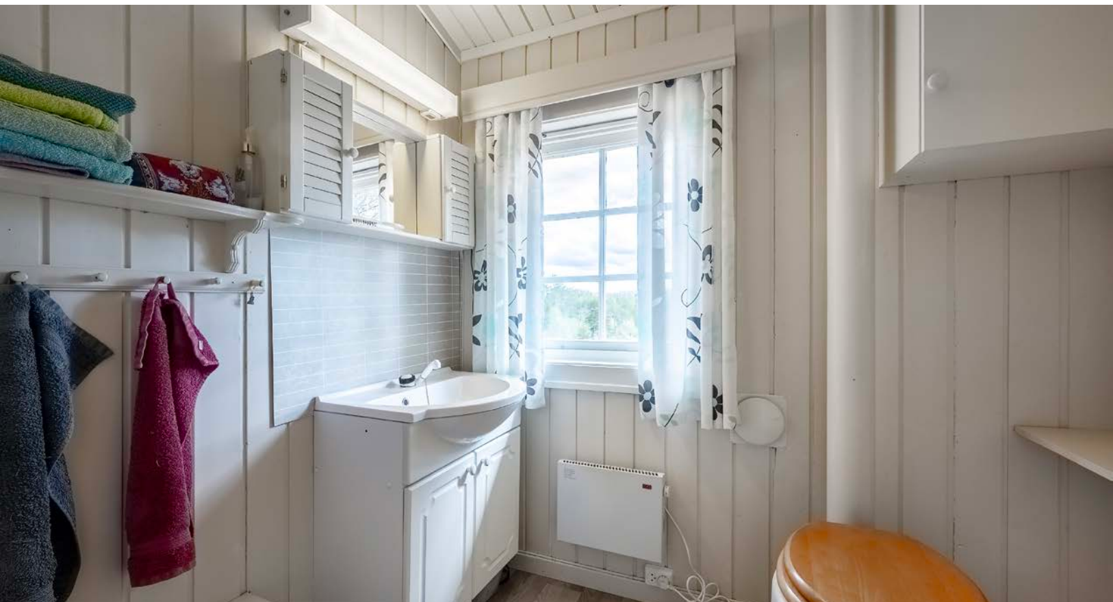
Vaskerom/toalettrom med servantinnredning og mulddo Hytta har helårsvann fra borebrønn til yttervegg/utvendig bod, men det er ikke lagt videre inn i hytta
