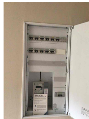
Sikringsskap mangler kursfortegnelse
