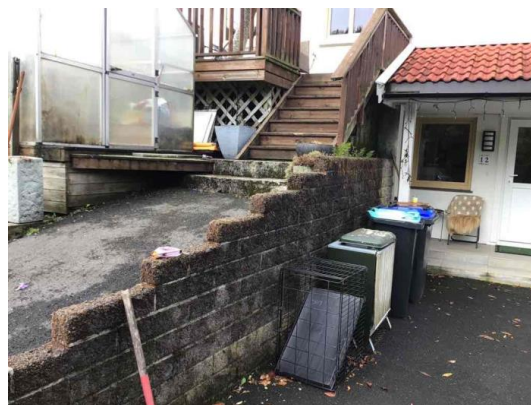
Mangler sikring langs mur mot gårdsplassen
