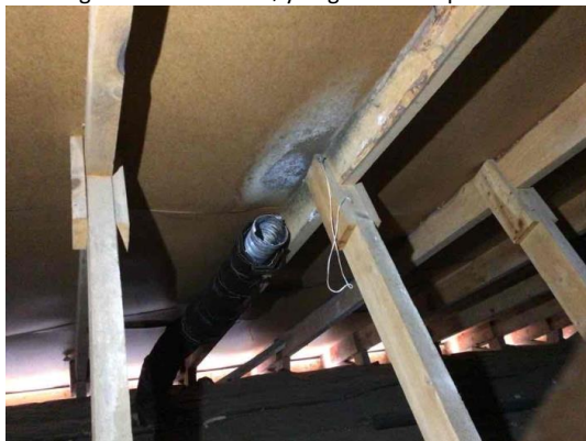
Lufting fra bad stopper under takplater
