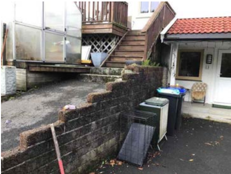
Mangler sikring langs mur mot gårdsplassen
