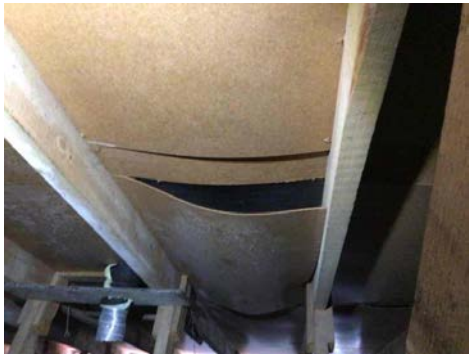
Undertak har glid ned i sammenføyninger enkelte plasser
