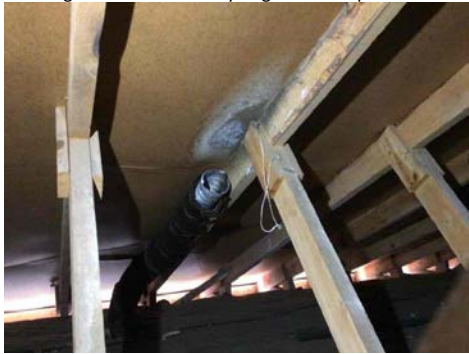
Lufting fra bad stopper under takplater
