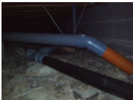
Avløpsrør i krypkjeller.
