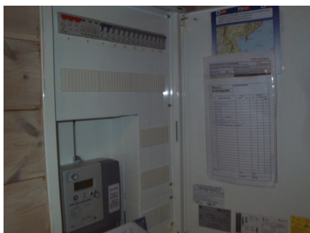
Sikringsskapet er plassert i gangen.
