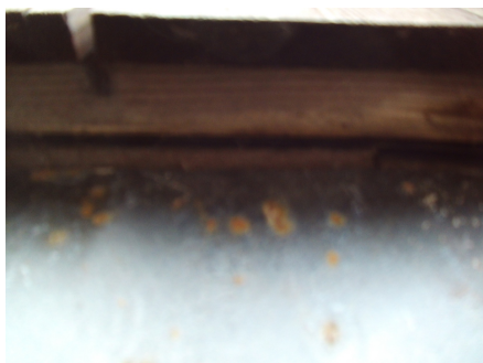
Noe tilgang på luft i mot ringmur.
