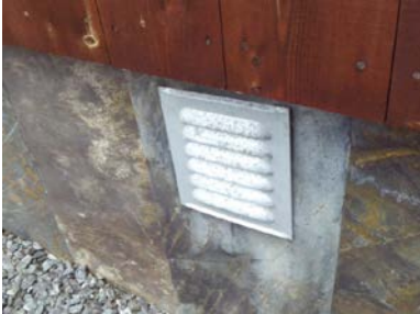
Bra med ventiler i ringmur.
