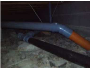
Avløpsrør i krypkjeller.
