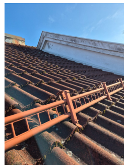
Påvist lekkasje i dette området mot nabo.
