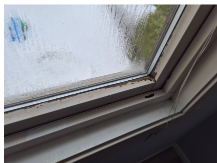
Værslitt og punktert vindu.
