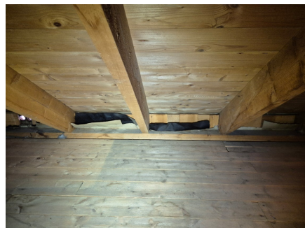
Lite lufting i nedre del mot gesims.
