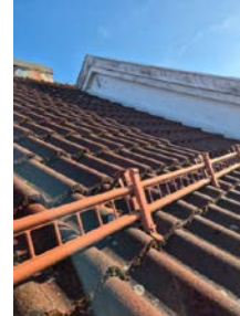
Påvist lekkasje i dette området mot nabo.
