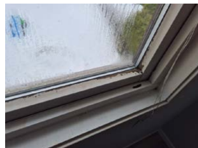
Værslitt og punktert vindu.
