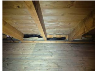
Lite lufting i nedre del mot gesims.
