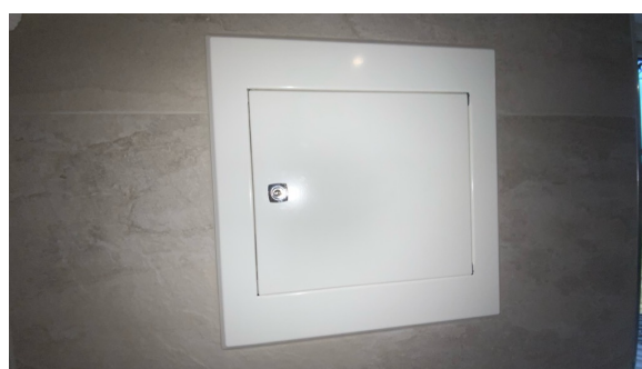
Fordelerskap for rør i rør på vad i 2 etasje.
