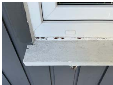
Mangler beslag under vinduet, fare for vann inn bak kledningen.
