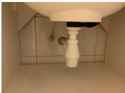
Røropplegg under vask på toalettrom.
