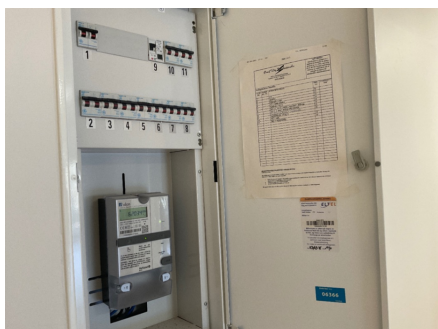
Sikringsskap i entre'.
