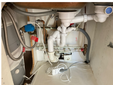
Røropplegg under kjøkkenvask.
