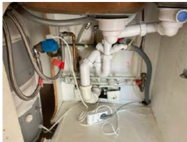
Røropplegg under kjøkkenskiv.
