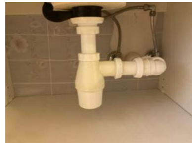
Røropplegg under badetromskiv.
