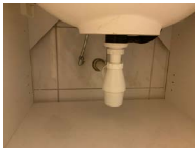
Røropplegg under vask på toalettrom.
