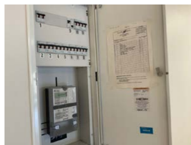
Sikringsskap i entre'.
