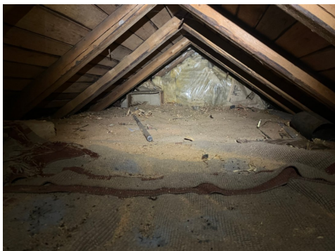
Møneloft må utbedres og undersøkes nærmere.
