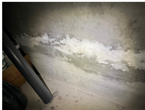
Saltutslag på vegg under tilbygg.
