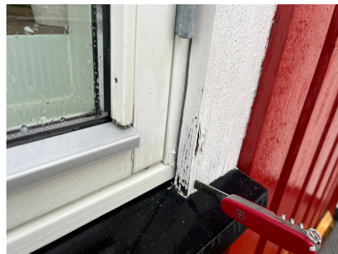
Dekkbord med råteskade grunnet manglende luftespalte ned til vannbrett.
