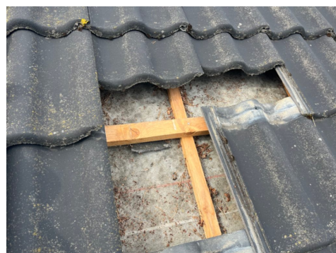
Stikkprøver viste undertaksduk under takstein.
