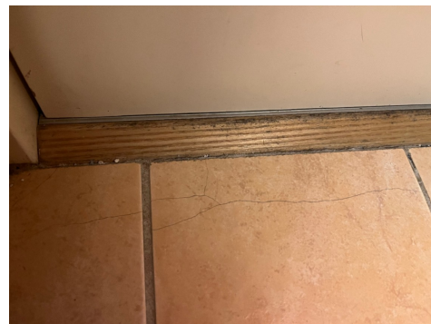
Sprekk i fliser foran ytterdør.
