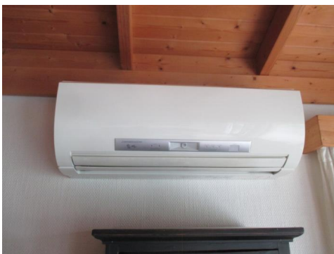
Varmepumpe i stue.
