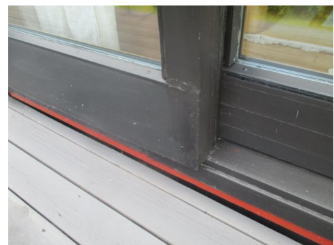
Noe slitt utvendig.
