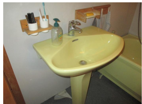
Eldre opprinnelig vvs utstyr.
