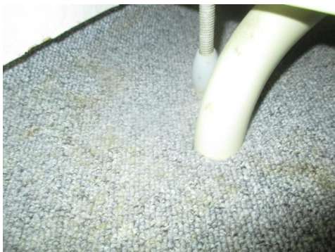
Ligger et filtteppe over sluk.
