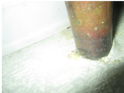
Ikke tett i rundt rørgjennomføringer i gulvet.
