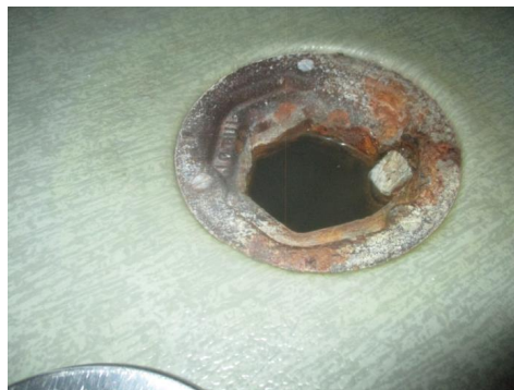
Eldre opprinnelig sluk.
