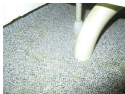
Ligger et filteppe over sluk.
