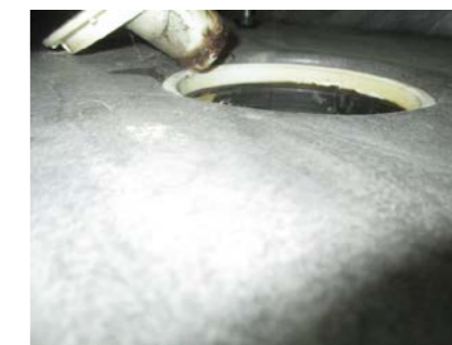
Sluk under dusjkabinett.
