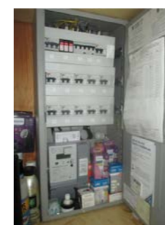
Sikringsskapet er plassert i bod.
