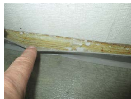
Plastlist i overgang gulv og vegg har løsnet.
