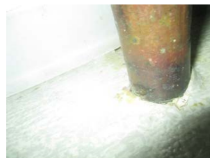
Ikke tett i rundt rørgjennomføringer i gulvet.
