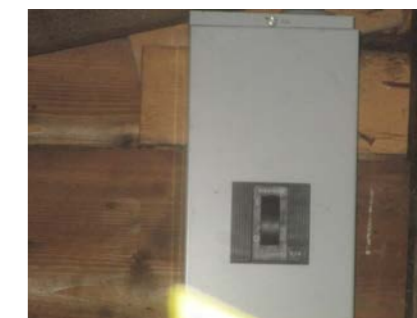
Hovedinntaket på loftet over tidligere carport.
