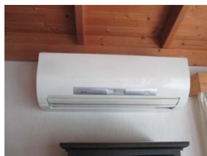
Varmepumpe i stue.
