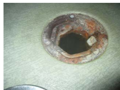
Eldre opprinnelig sluk.
