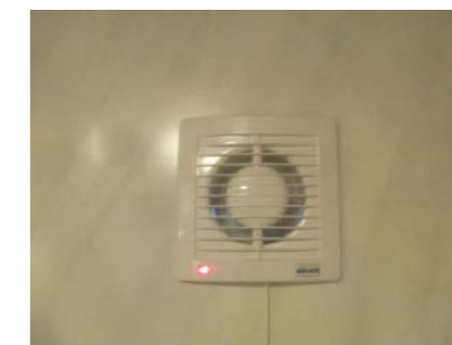
Vifte i ytterveggen.
