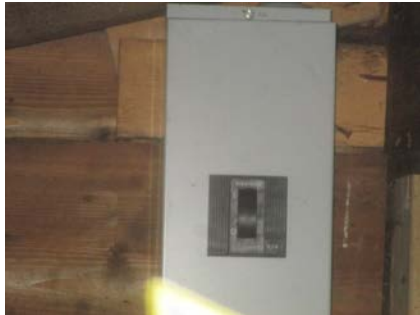
Hovedinntaket på loftet over tidligere carport.
