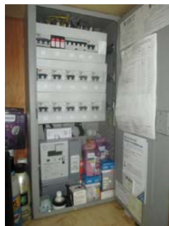
Sikringsskapet er plassert i bod.
