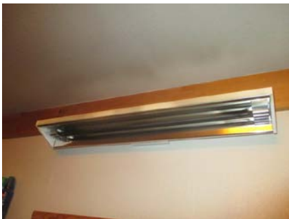
Strålovn på veggen som varmekilde.
