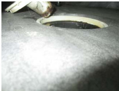
Sluk under dusjkabinett.
