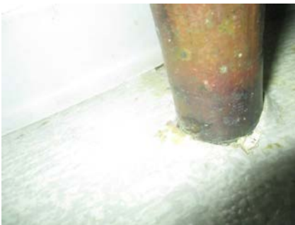
Ikke tett i rundt rørgjennomføringer i gulvet.
