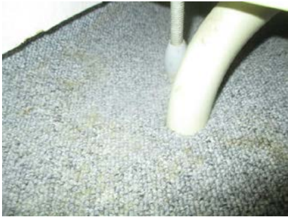
Ligger et filtteppe over sluk.
