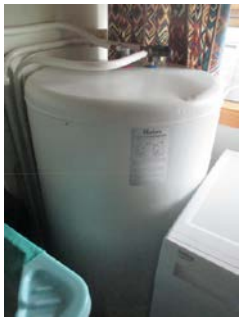
Eldre bereder er plassert på vaskerommet.
