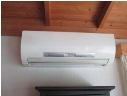
Varmepumpe i stue.
