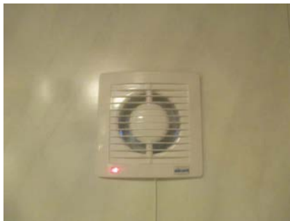
Vifte i ytterveggen.
