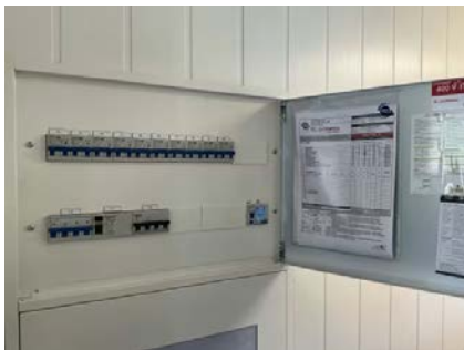
Sikringsskap står i bod/teknisk med utvendig adkomst.
