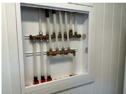
Rør-fordeling er ikke merket.
