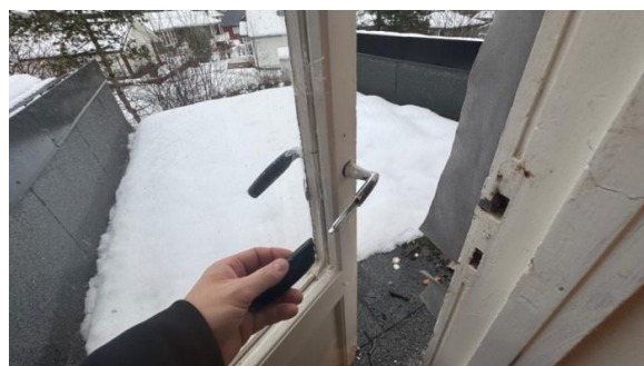
Dørrider er defekt.
