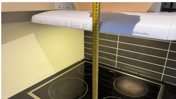
Avstand mellom platetopp og kjøkkenventilator er for liten i forhold til dagens krav.
