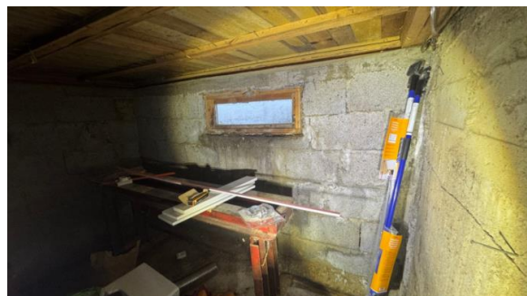
Det er fuktgjennomtrenging gjennom vindu.
