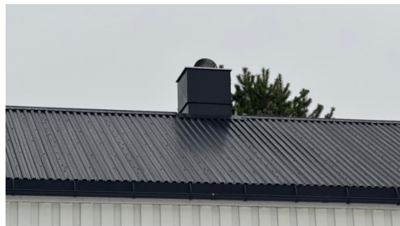
Det er ikke montert snøfangere.
