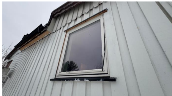
Løs pakning på vindu.
