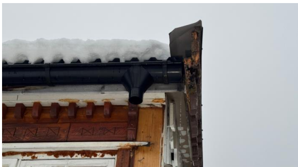
Manglende endelokk og nedløp.
