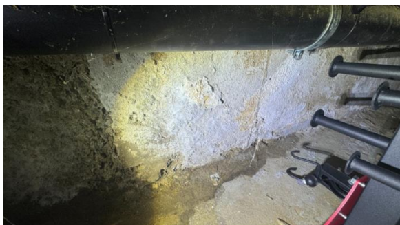
Det er registrert en del saltutslag.
