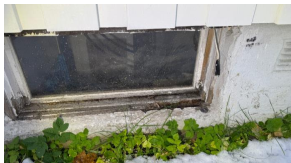
Råteskade i vindu.
