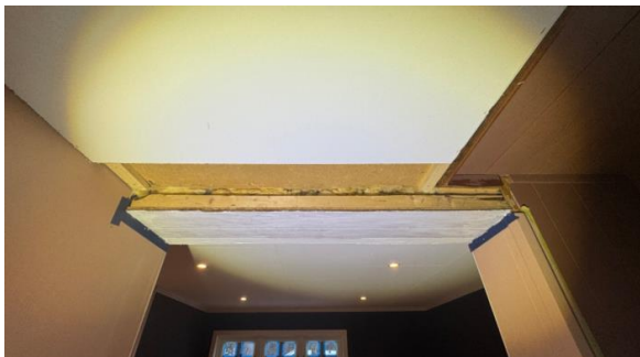
Manglende himlingsplater og avslutninger.
