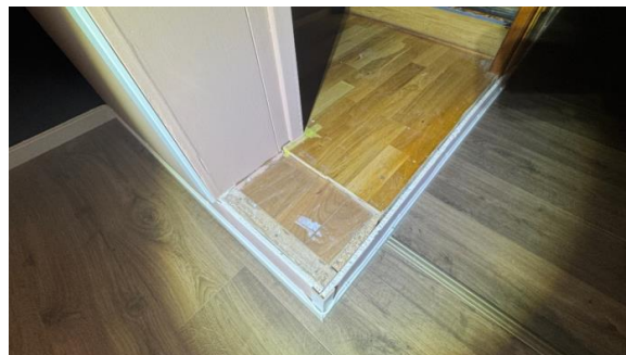
Repos i 1. etasje mangler delvis gulvtekking.
