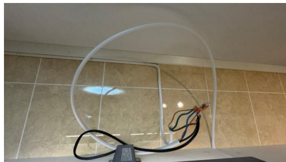
Kabler er ikke tilfredsstillende festet.
