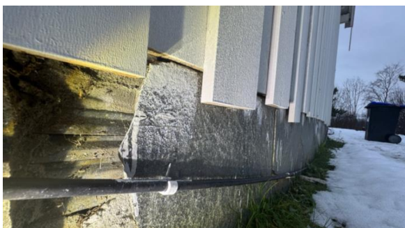
Stedvis manglende lufting.
