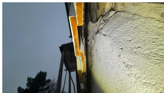
Det er ingen musesperre i nedre kant av konstruksjon.
