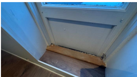
Det er utettheter mellom dørblad og karm.
