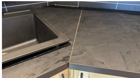
Skjøter på benkeplaten er ikke fagmessig utført.
