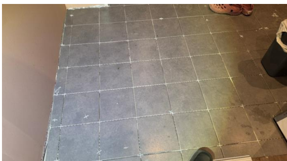
Manglende fuger i fliser.
