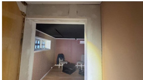
Manglende omramming/sparkling i døråpninger.
