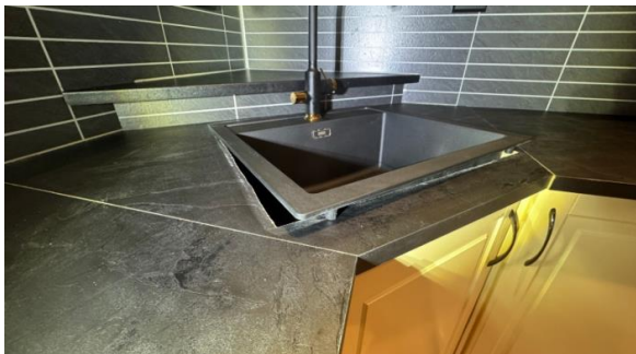
Kjøkkenvasken er ikke limt/festet til benkeplaten.
