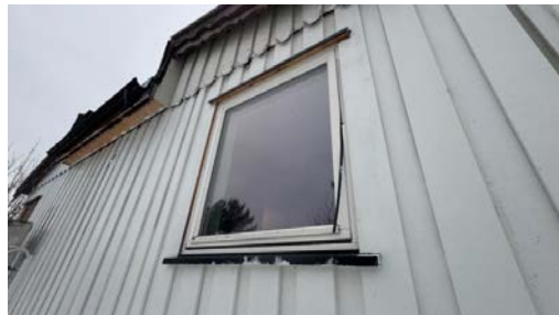
Løs pakning på vindu.
