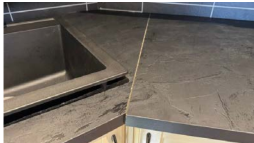
Skjøter på benkeplaten er ikke fagmessig utført.
