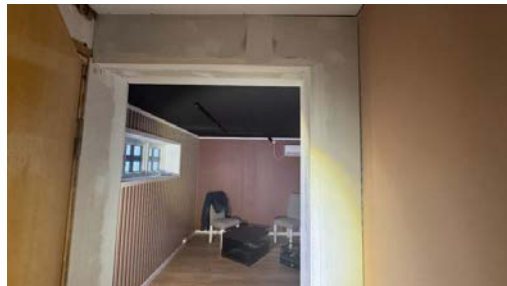
Manglende omramming/sparkling i døråpninger.
