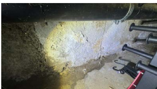
Det er registrert en del saltutslag.
