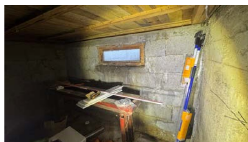
Det er fuktgjennomtrenging gjennom vindu.
