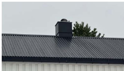
Det er ikke montert snøfangere.
