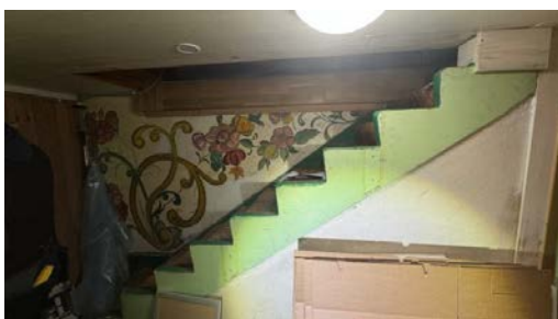
Kjellertrappen mangler rekkverk.
