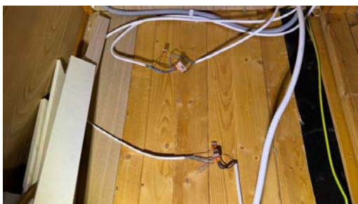
Kabler og koblinger er ufagmessig utført.
