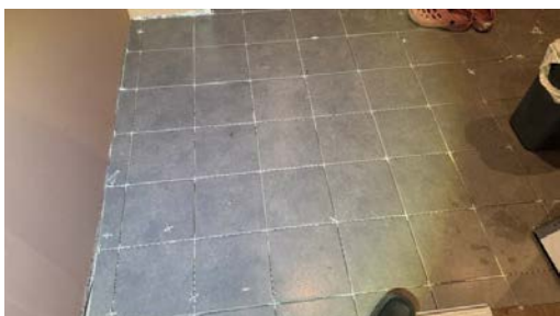
Manglende fuger i fliser.
