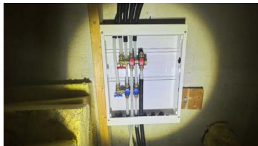
Rørkursene på rør-i-rør systemet på vannledninger er ikke merket.
