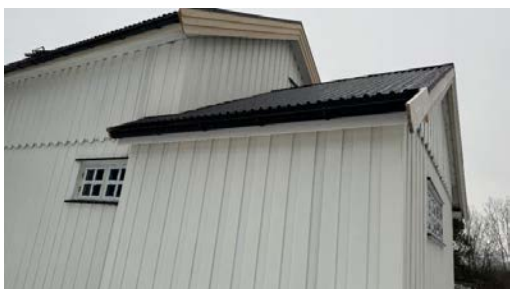
Det er ikke etablert nedløp. Ved mye nedbør vil vann renne over takrennen.
