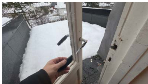
Dørriider er defekt.
