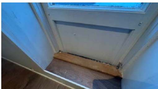
Det er utettheter mellom dørblad og karm.
