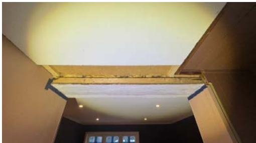
Manglende himlingsplater og avslutninger.
