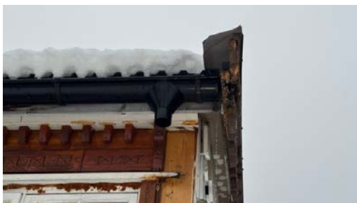
Manglende endelukk og nedløp.
