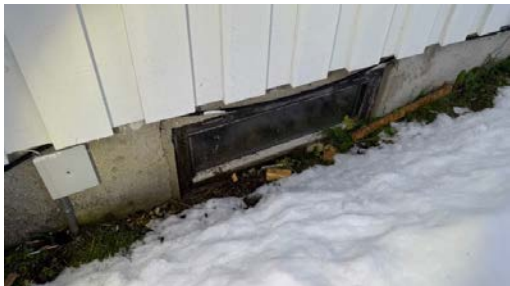
Vindu er delvis under planert terreng.
