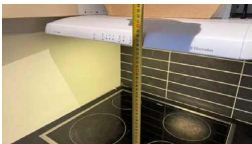
Avstand mellom platetopp og kjøkkenventilator er for liten i forhold til dagens krav.
