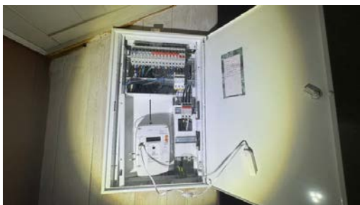
Kontroll av el-skap og kursfortegnelse.
