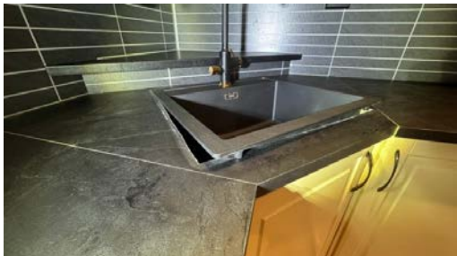
Kjøkkenvasken er ikke limt/festet til benkeplaten.
