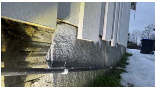
Stedvis manglende lufting.
