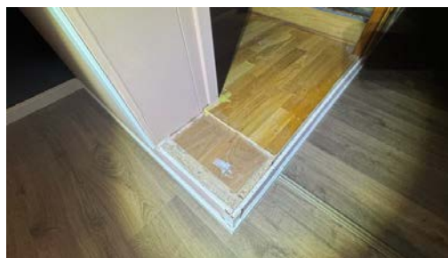
Repos i 1. etasje mangler delvis gulvtekking.
