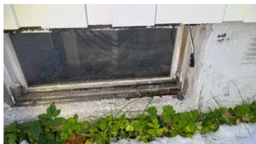
Råteskade i vindu.
