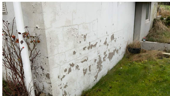
Riss i puss og malingsflass
