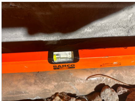
Avløp til med feil fall
