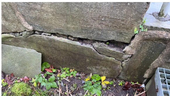
Sprekk i fundament
