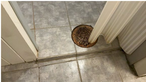
Sluk i åpning mot gang
