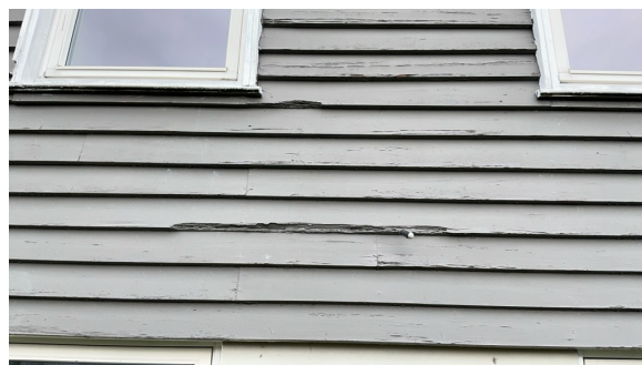
Råte i kledning
