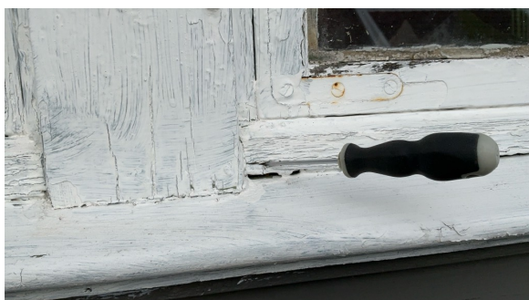
Det er registrert råte på vindu
