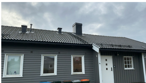
Mangler noe snøfangere på begge sider av taket
