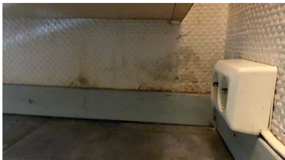
Svertesopp under baderomsinnredning
