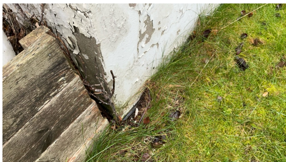
Klemlest til fuktsikring synlig
