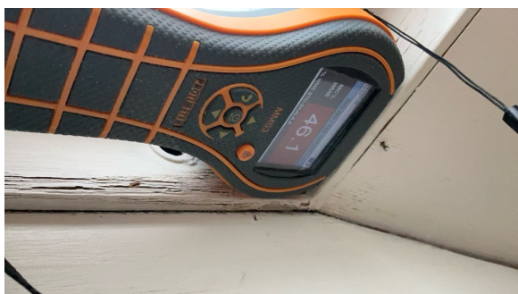
Vindu på gang, høy fuktighet registrert
