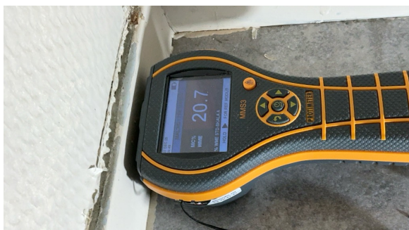
Fuktighet i gulvlist på soverom
