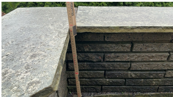
Rekkverk/kant for lav
