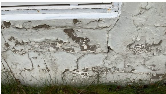
Sprekkdannelser i mur
