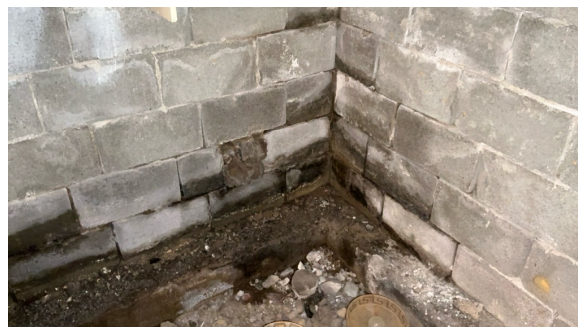
Fuktighet på mur
