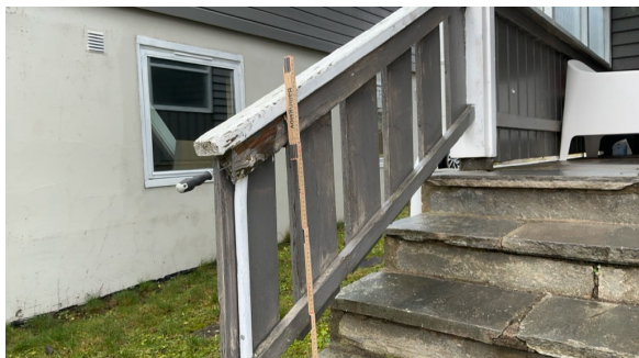
Råte og for lavt rekkverk
