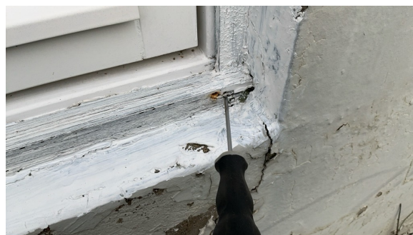
Det er registrert råte i listverk
