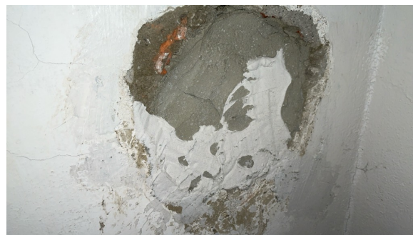
Noe manglende puss og overflatebehan
