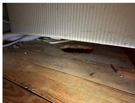
Hull i gulv under oppvaskmaskin
