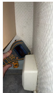
Indikasjoner på fukt ved fuktsøk i området med svertesopp (Fuktsøk verdi 483)
