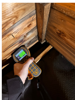
Fuktskjolder uten registret fuktighet.
