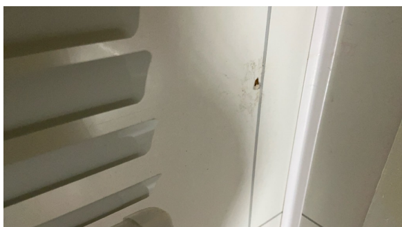
Skade på platen
