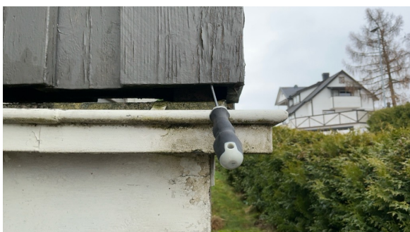
Råte i rekkverk
