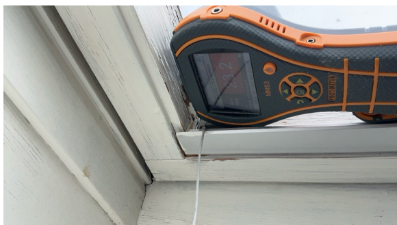
Vindu på soverom, høy fuktighet registrert
