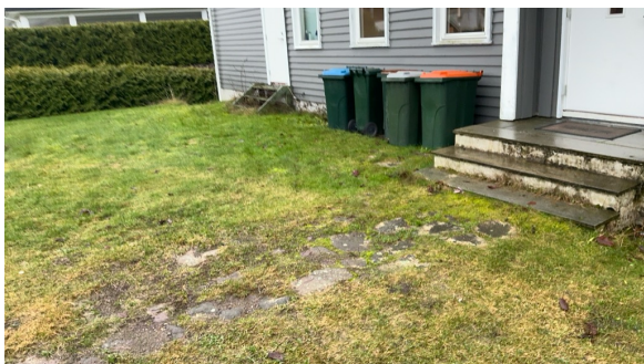
Dårlig fall fra bolig/kjellermur
