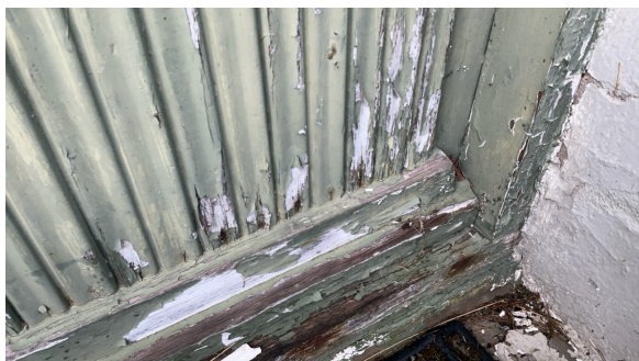
Slitasje på kjellerdør
