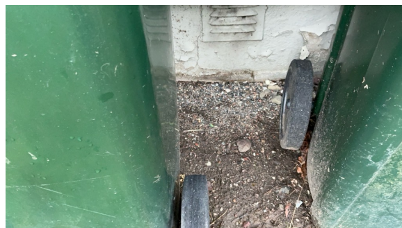
Ingen fuktsikring synlig
