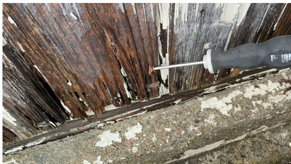
Kjellerdør med råteskade
