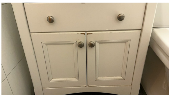
Det er påvist noe svelling og overflateskade på baderomsinnredningen
