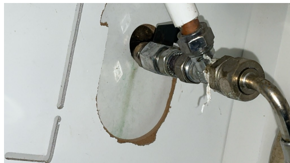
Manglende tetting rundt rørgjennomføring
