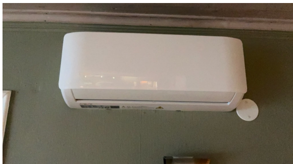
Varmepumpe i stue
