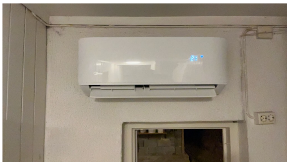
Varmepumpe i kjeller
