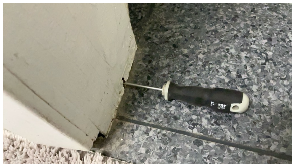
Råte i foring
