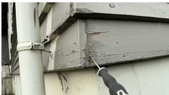
Råte i kledning
