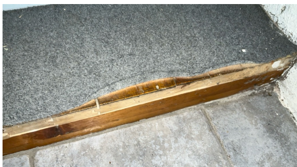
Slitasje på teppe
