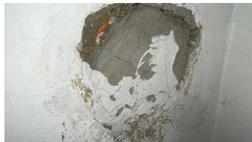
Noe manglende puss og overflatebehan
