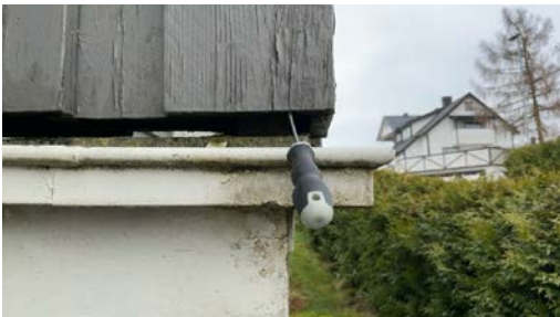
Råte i rekkverk
