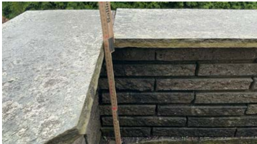
Rekkverk/kant for lav
