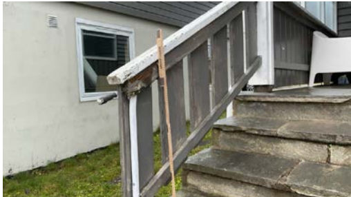
Råte og for lavt rekkverk
