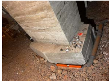
Avløp til med feil fall
