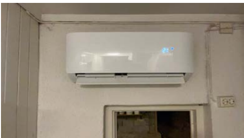
Varmepumpe i kjeller
