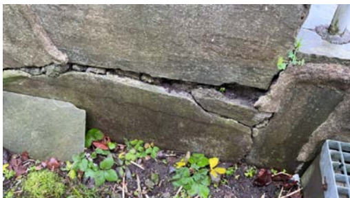
Sprekk i fundament
