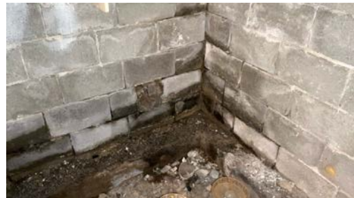
Fuktighet på mur
