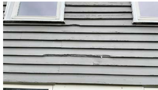
Råte i kledning
