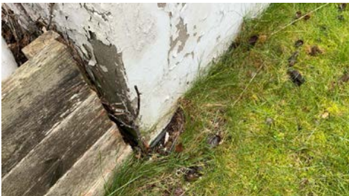
Klemlist til fuktsikring synlig
