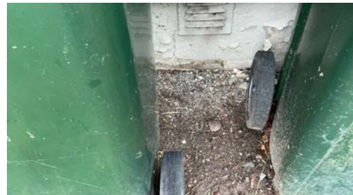
Ingen fuktsikring synlig
