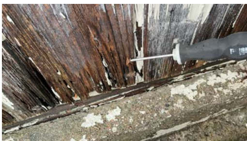
Kjellerdør med råteskade
