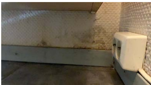
Svertesopp under baderomsinnredning
