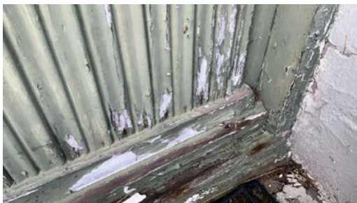
Slitasje på kjellerdør
