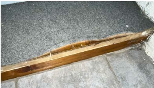
Slitasje på teppe
