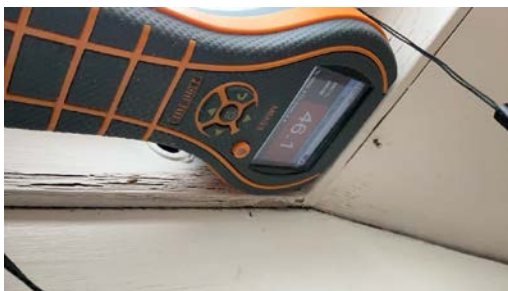
Vindu på gang, høy fuktighet registrert
