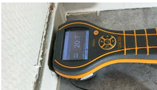
Fuktighet i gulvlist på soverom
