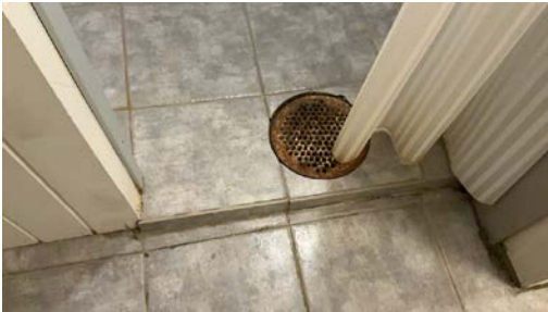
Sluk i åpning mot gang
