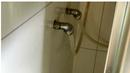
Manglende tetting rundt rørgjennomføring
