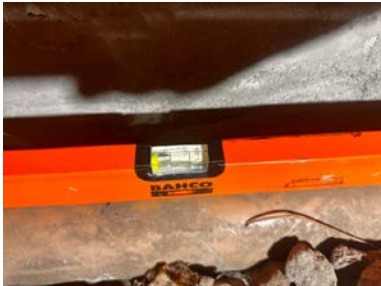
Avløp til med feil fall
