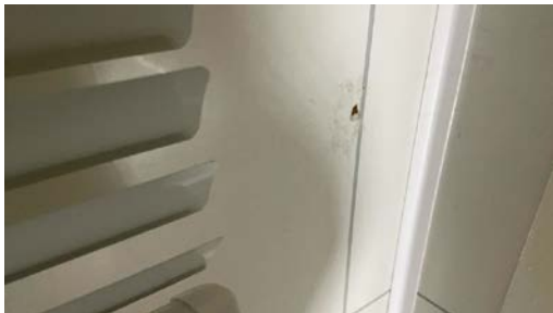
Skade på platen
