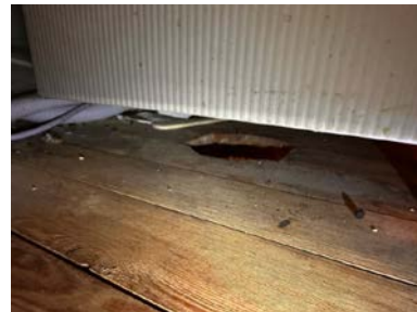
Hull i gulv under oppvaskmaskin
