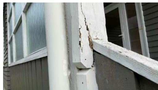
Råte i søyle
