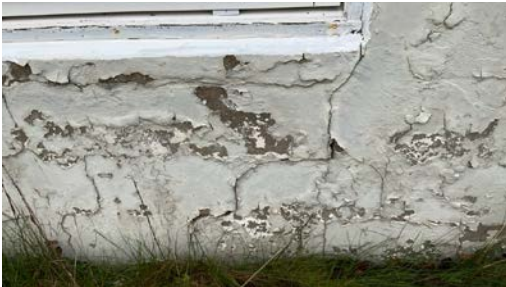
Sprekkdannelser i mur
