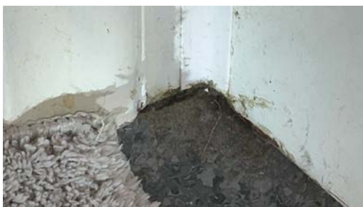
Vinyl uten oppbrett ved dør (går ikke opp bak baderomsplatene)
