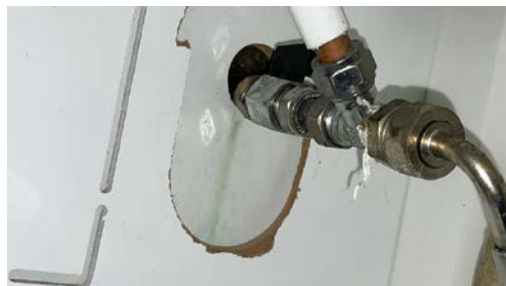
Manglende tetting rundt rørgjennomføring
