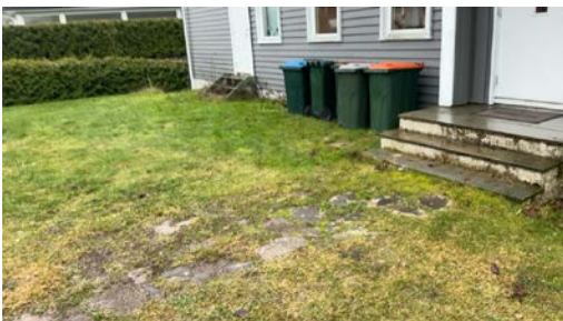
Dårlig fall fra bolig/kjellermur
