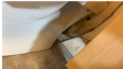
Manglende overflatebehandling bak toalett
