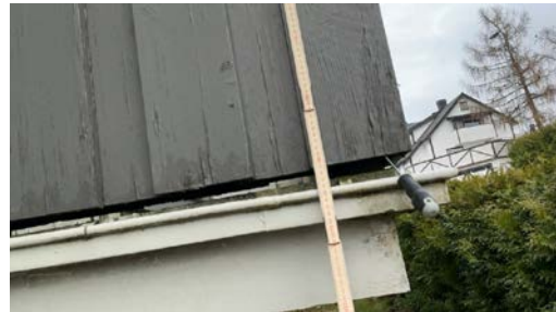
Rekkverk for lavt
