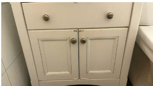
Det er påvist noe svelling og overflateskade på baderomsinnredningen
