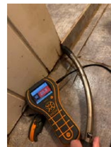
Fuktutslag ved måling på vegg i gang ved åpning til dusj/våtrom
