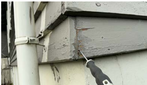
Råte i kledning
