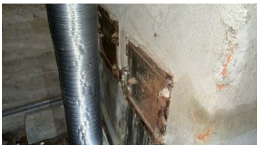
Renninger fra sotluke/feieluke
