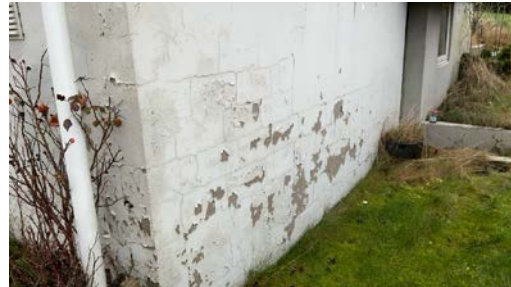
Riss i puss og malingsflass
