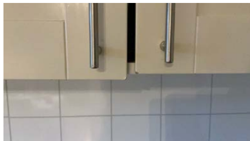
Manglende justering av kjøkkenfronter
