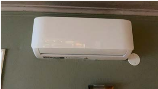
Varmepumpe i stue
