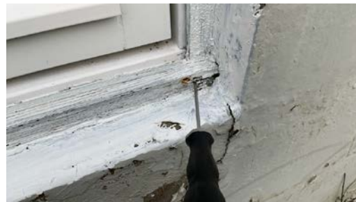
Det er registrert råte i listverk
