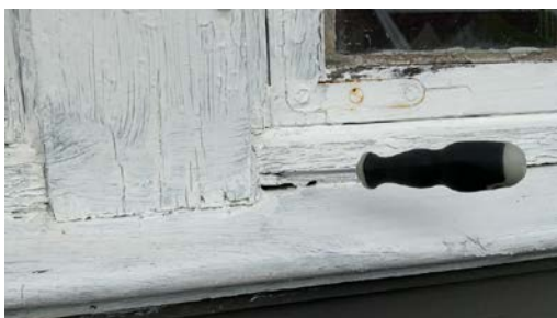
Det er registrert råte på vindu
