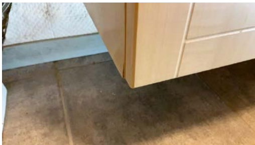
Skade på baderomsinnredning
