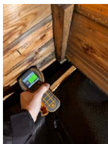
Fuktskjolder uten registrert fuktighet.
