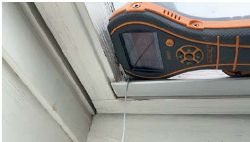
Vindu på soverom, høy fuktighet registrert
