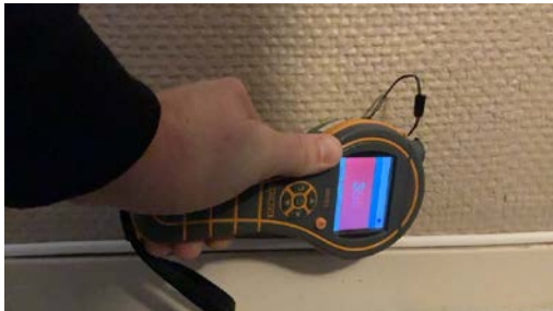
Fuktutslag i vegg på soverom
