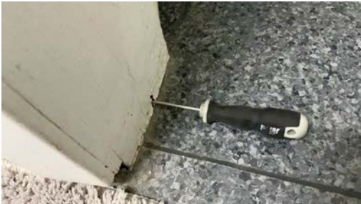
Råte i foring
