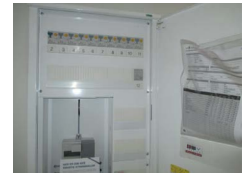
Sikringsskap med merkede kurser.
