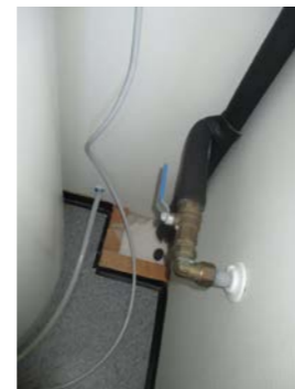
Innvendig stoppekran ved bereder på hotellrommet
