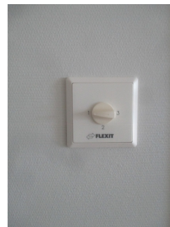
Ventilasjonen styres i fra kjøkkendelen.
