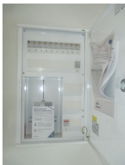
Sikringsskapet er plassert ved kjøkkendelen
