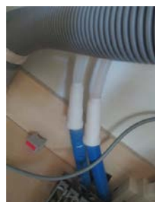
Deler av rør i rør systemet i kjøkkenbenken.
