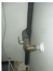
Innvendig stoppekran på hotellrom.
