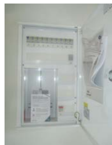
Sikringskapet er plassert ved kjøkkendelen
