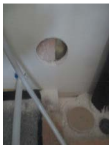
Hulltaking i fra skap ved bereder.
