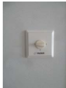
Ventilasjonen styres i fra kjøkkendelen.
