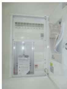
Sikringsskapet er plassert ved kjøkkendelen
