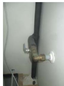
Innvendig stoppekran på hotellrom.
