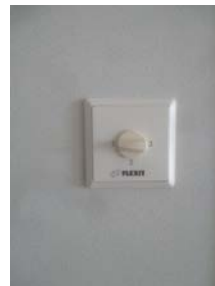
Ventilasjonen styres i fra kjøkkendelen.
