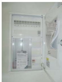
Sikringskapet er plassert ved kjøkkendelen
