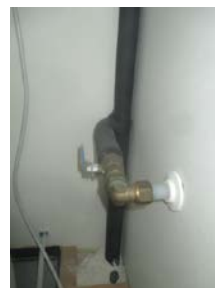
Innvendig stoppekran på hotellrom.
