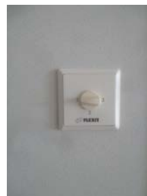
Ventilasjonen styres i fra kjøkkendelen.
