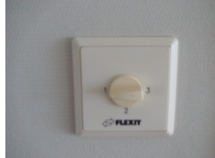
Styring av anlegget i gangen.
