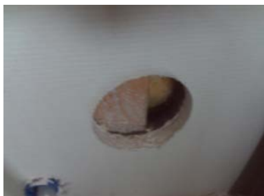
Hulltaking fra skap til bereder.
