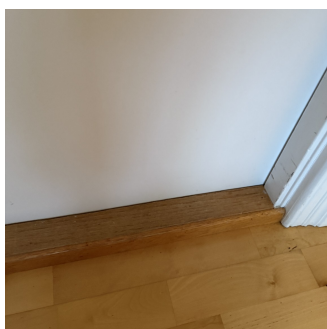
Manglende luftespalte under dør
