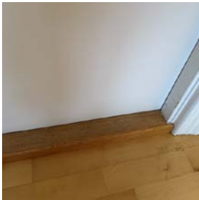
Manglende luftespalte under dør
