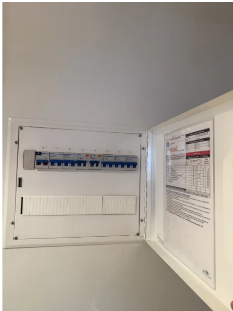
Sikringsskap er plassert i entre/gang. Kursoversikt på innside skapdør.
