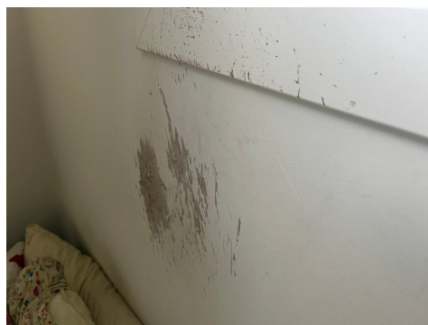
Skader på vegger
