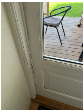
Skade og dårlig pakning på dør.
