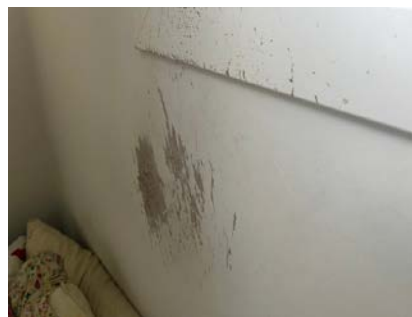
Skader på vegger
