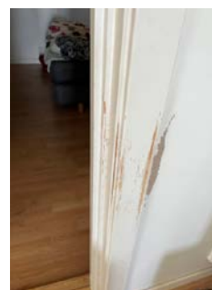
Skade på vegg og dør/listverk
