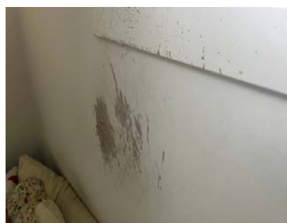
Skader på vegger
