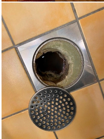
Eldre sluk på bad
