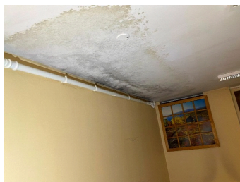
Sopp i himling i innredet rom i kjeller
