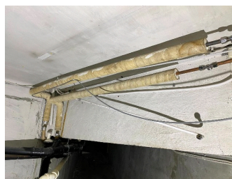
Rørisolasjon av ukjent type - kan inneholde asbest
