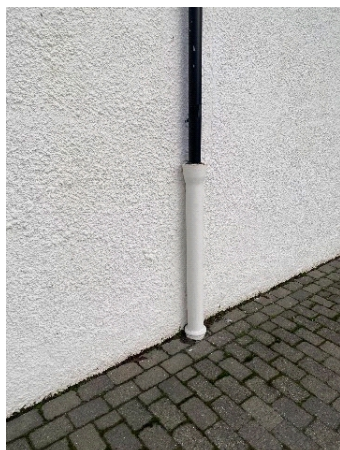
Opprinnelig soilrør som kommer opp fra bakken
