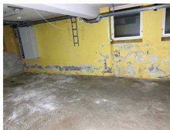
Fukt i kjeller
