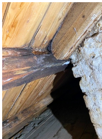
Lekkasje omkring pipe
