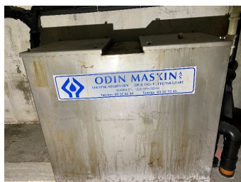
Fettutskiller plassert i kjeller
