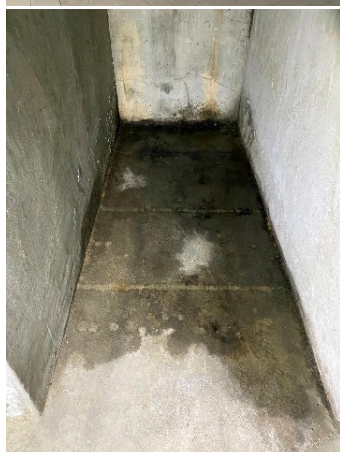
Lekkasje fra aluminiumsluke
