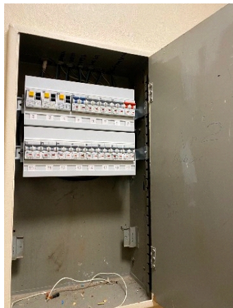
Sikringskap til leilighet
