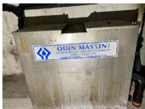
Fettutskiller plassert i kjeller
