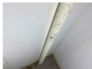
Svertesopp i kjølerom i varemottak
