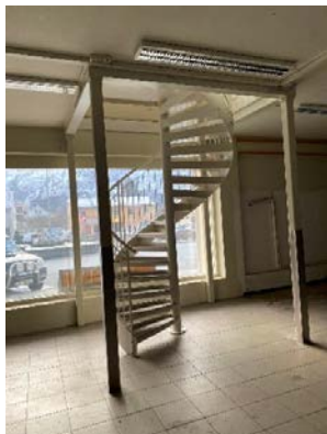
Trapp fra butikk til kontorer
