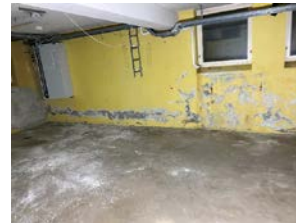
Fukt i kjeller
