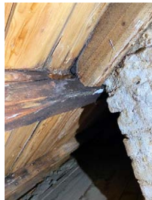
Lekkasje omkring pipe
