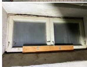
Eldre kobla kjellervindu som er tettet utvendig over bakken
