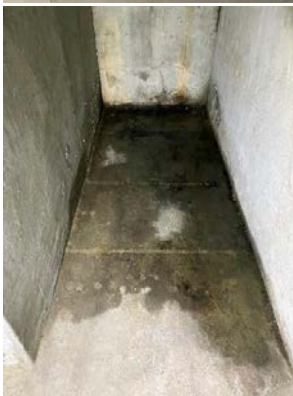
Lekkasje fra aluminiumsluke
