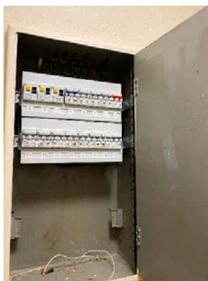
Sikringskap til leilighet
