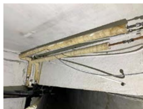
Rørisolasjon av ukjent type - kan inneholde asbest
