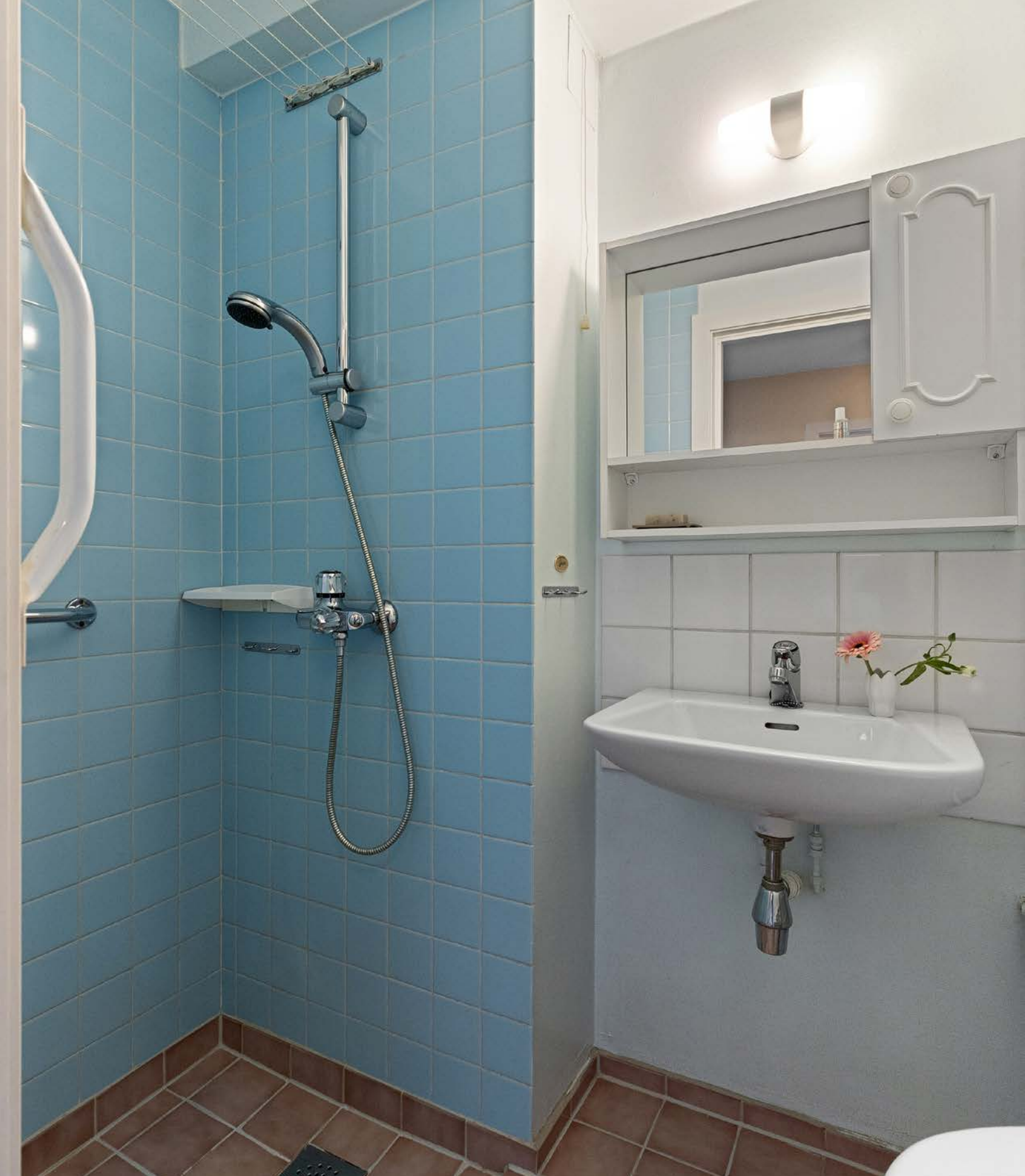
Eldre baderom med fliser på gulv. Fliser og malt mur på vegger. Malt betonghimling.
