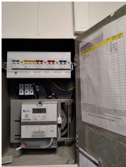
Sikringsskap er plassert i felles trappegang.
