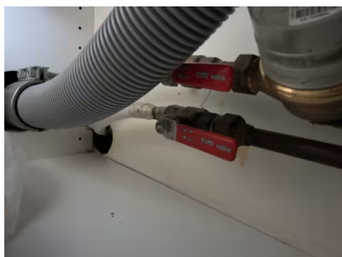
Hovedstoppekraner er plassert i kjøkkeninnredning.
