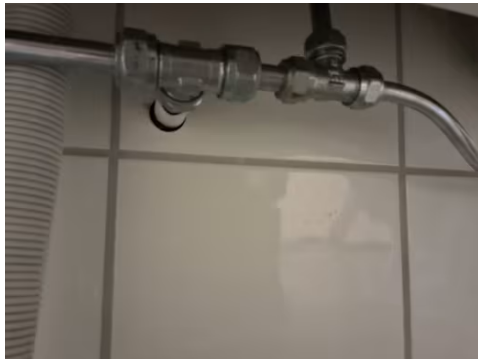
Utettheter rundt rørgjennomføring.
