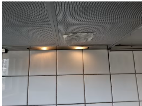
Kjøkkenventilator er testet med papir.
