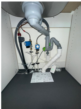
Røropplegg i kjøkkenbenk med Waterguard
