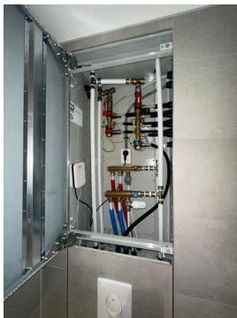
Samleskap med rørkurser og stoppekraner
