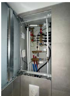
Samleskap med rørkurser og stoppekraner
