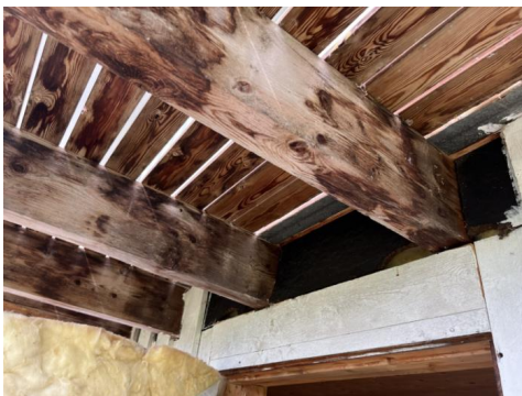
Ubehandlet trevirke og åpning mot veggkonstruksjon
