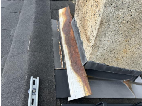
Rust og utettheter i pipe/fotbeslag
