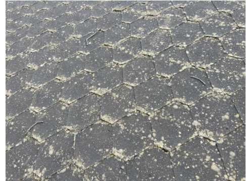
Slitasje og mosedannelse på tekking
