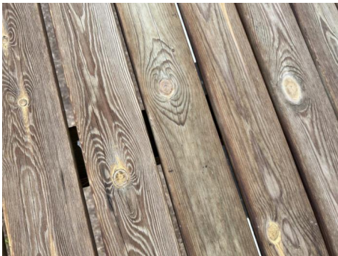
Mangelfull innfesting og løse terrassebord
