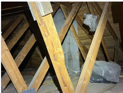
Fuktskjolder på pipestamme
