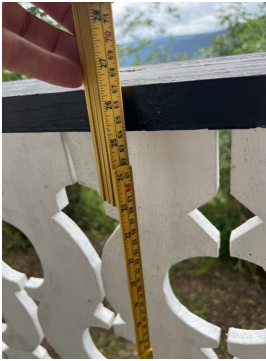
Rekkverk er for lavt ihenhold til krav
