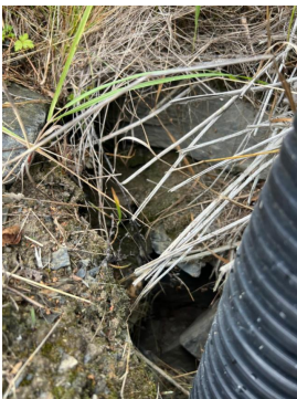
Påbegynnende utgliding trolig som følge av jordpress
