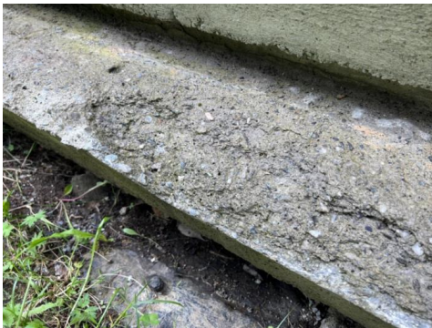
Avskalling av betong
