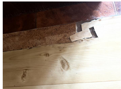
Skader på overflater
