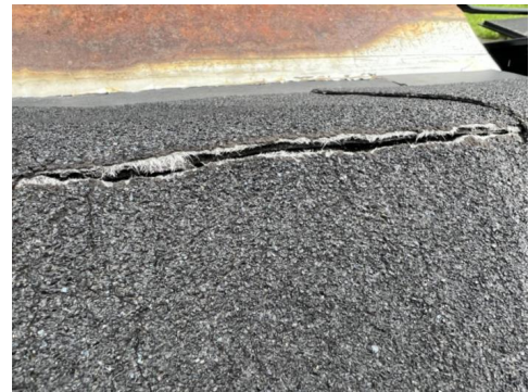
Skade på tekking
