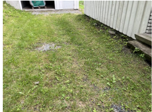
Dårlig fall bort fra bygningskropp på overside
