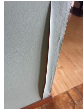
Slitasje på overflatersom har oppnådd forventet levetid
