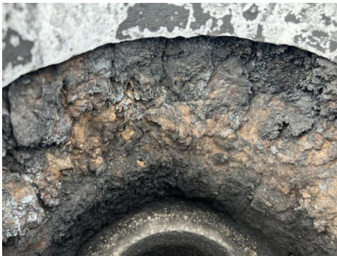
Manglende innerør over tak, synlig påbegynnende forkulling av isolasjon
