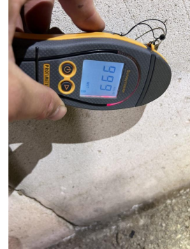
Ved fuktmåletaking av gulv på grunn og yttermurer er det fuktutslag
