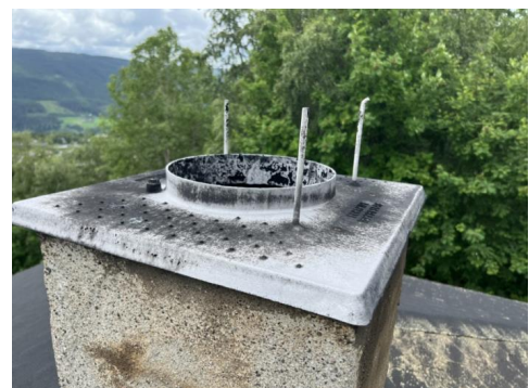
Manglende pipetopp som bør skiftes
