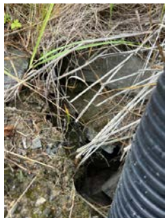
Påbegynnende utgliding trolig som følge av jordpress
