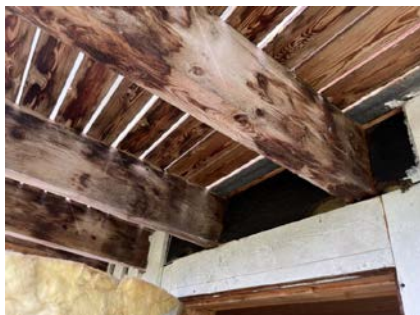
Ubehandlet trevirke og åpning mot veggkonstruksjon
