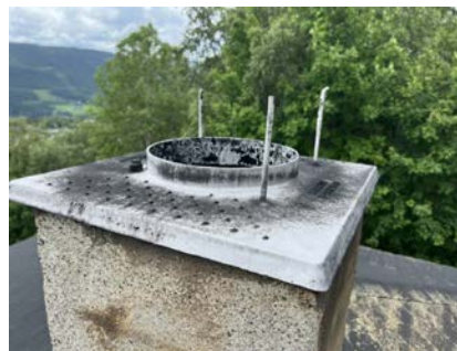
Manglende pipetopp som bør skiftes
