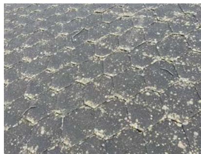
Slitasje og mosedannelse på tekking
