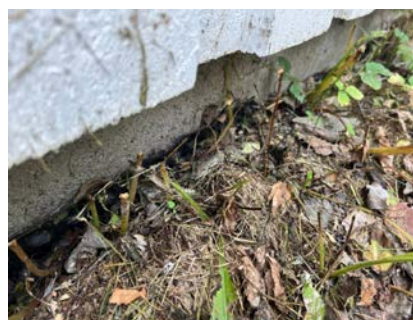
Synlig knotteplast mot mur, stedvis avsluttet under terreng
