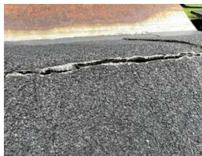
Skade på tekking
