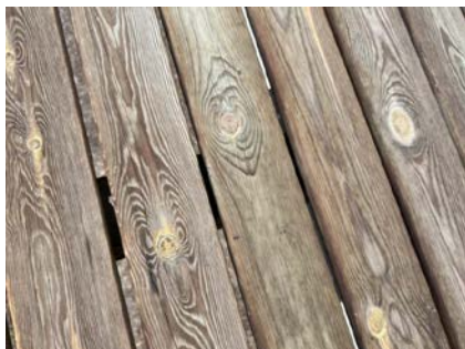
Mangelfull innfesting og løse terrassebord
