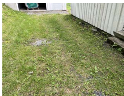
Dårlig fall bort fra bygningskropp på overside
