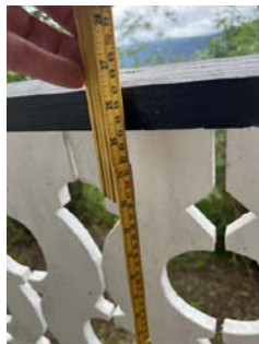
Rekkverk er for lavt ihenhold til krav
