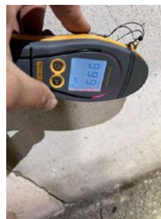
Ved fuktmåletaking av golv på grunn og yttermur er det fuktutslag
