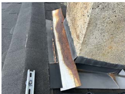
Rust og utettheter i pipe/fotbeslag
