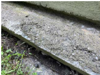
Avskalling av betong
