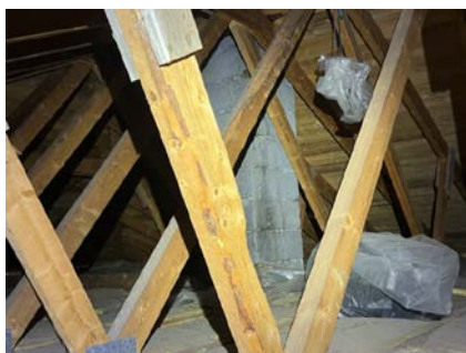
Fuktskjolder på pipestamme
