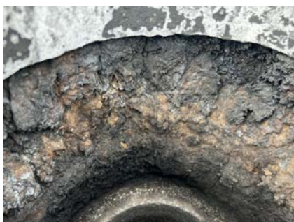
Manglende innerør over tak, synlig påbegynnende forkulling av isolasjon
