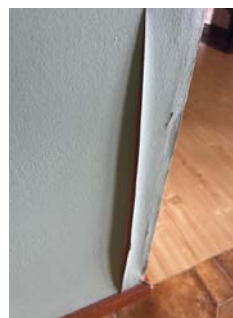
Slitasje på overflatersom har oppnådd forventet levetid
