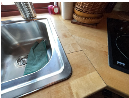
Sprekk i benkeplate
