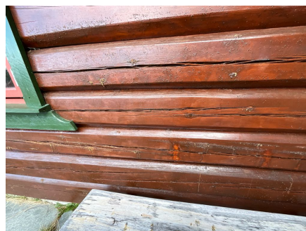
Bilde som viser omtalte sprekker i tømmeret
