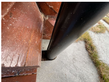
Taknedløp med frostspreng
