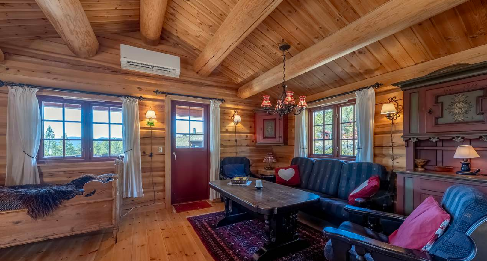
Varmepumpe installert høsten 2024
