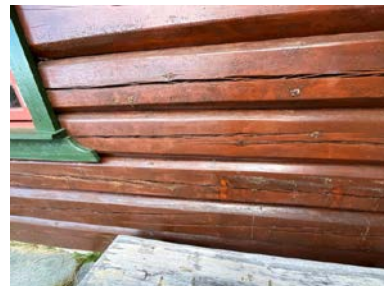
Bilde som viser omtalte sprekker i tømmeret
