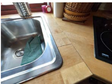
Sprekk i benkeplate
